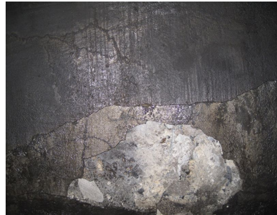
[해설 사진 2.2.15] 라이닝보수부의 박락
