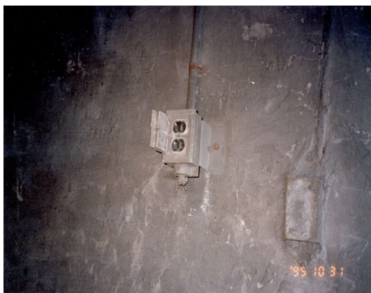
[해설 사진 2.2.25] 상태가 양호한 전원
