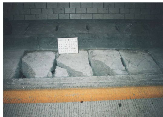
[해설 사진 2.2.56] 배수구 덮개 파손
