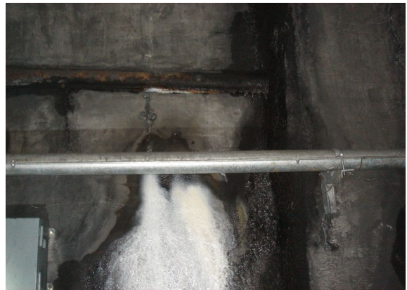
f. 터널 벽체에서의 누수 및 백태
