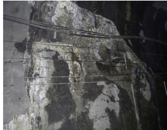
[해설 사진 2.2.13] 라이닝 보수부의 붕락(파손)
