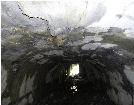
[해설 사진 2.2.12] 터널의 천장부 붕락(변형)
