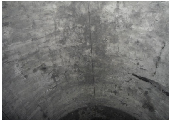
h. 터널 천장 보수부 망상균열
