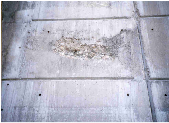
c. 콘크리트 탈락
