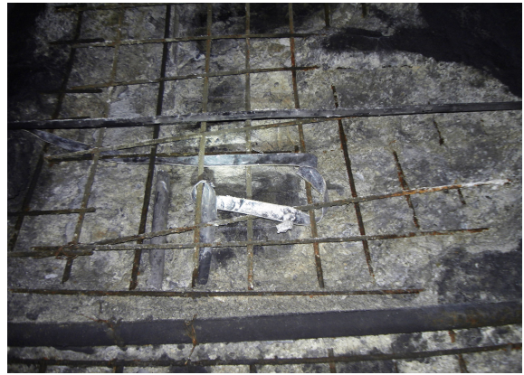
d. 철근노출, 부식 및 콘크리트박락
