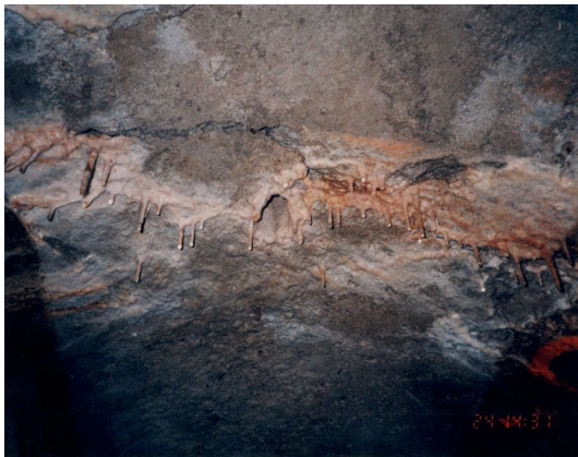
[해설 사진 2.2.16] 터널 천장부에 발생한 백태
