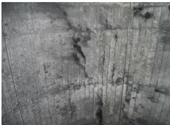
[해설 사진 2.2.1] 천장부에 발생한 종방향 균열
