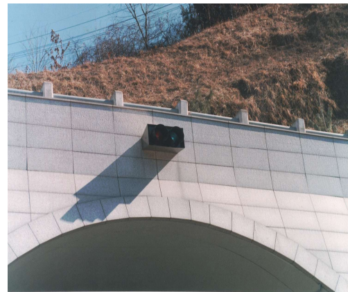
[해설 사진 2.2.45] 터널내부 전기상태 표시등
