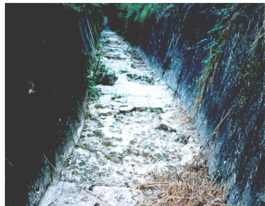
[해설 사진 2.2.40] 배수로 바닥 파손
