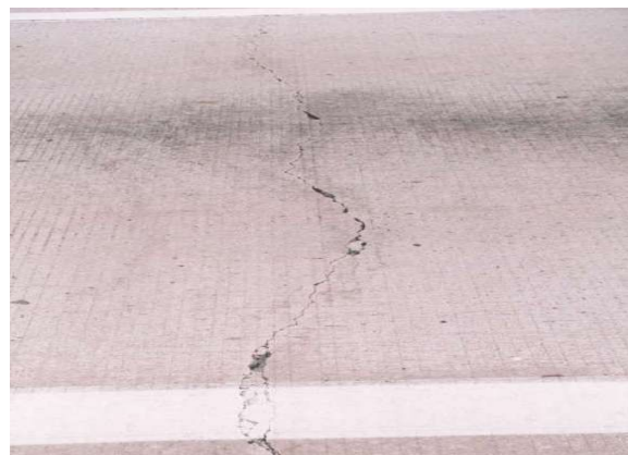
[해설 사진 2.2.2] 도로 바닥면에 발생한 균열
