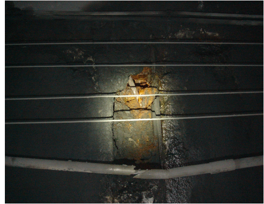
[해설 사진 2.2.9] 토사유출, 세굴에 의한 공동
