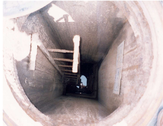
[해설 사진 2.2.42] 수직통로의 정작불량 사다리
