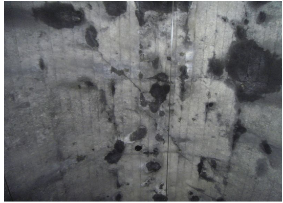
b. 천장에서 발생한 균열
