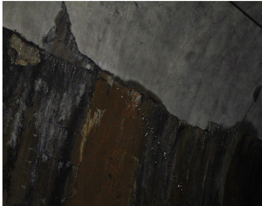
[해설 사진 2.2.4] 철도터널 측벽부의 누수
