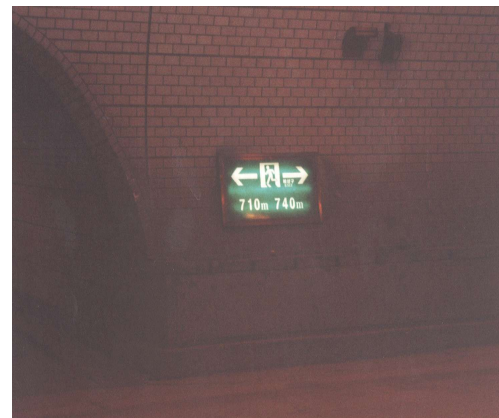
[해설 사진 2.2.47] 터널내부 위치표시등
