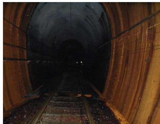
[해설 사진 2.2.7] 철도터널의 적색누수 전경
