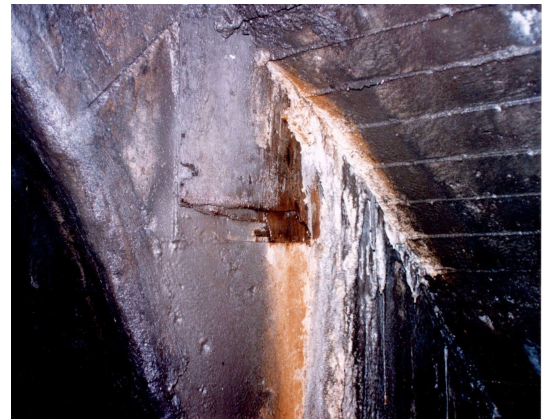
[해설 사진 2.2.17] 대형대피소 연결 어깨부의 백태
